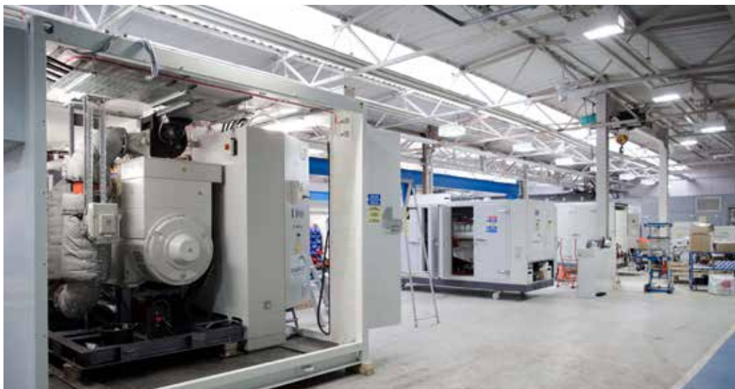
FIGURA 2 - ENER-G segue internamente tutti gli aspetti dei progetti degli impianti di cogenerazione, dalla fase iniziale della progettazione all'assistenza a lungo termine nella fase dell'installazione
